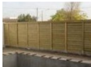
Barrière de protection pleine
